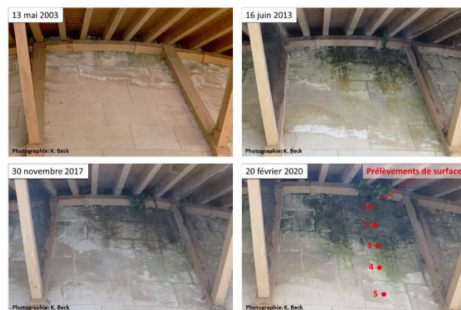
Figure 1 – Evolution de l'altération des pierres sur le manège des écuries et zone de prélèvements
